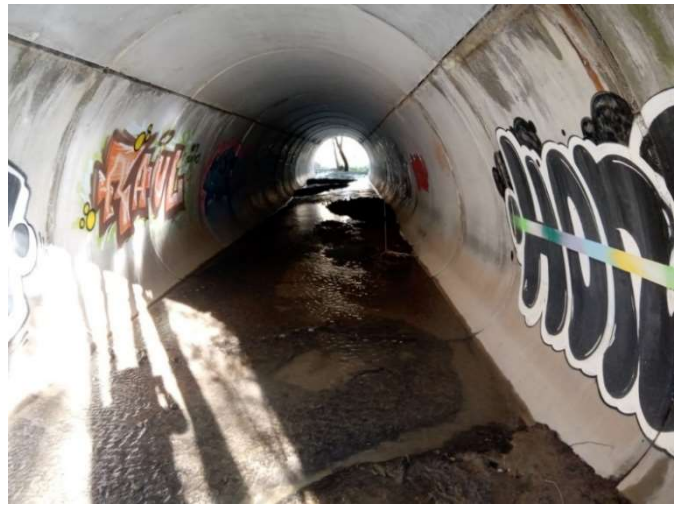
Vista del arroyo Berresoaga, bajo el vial del polígono de Larrabetzu, sin paso de fauna adaptado.
